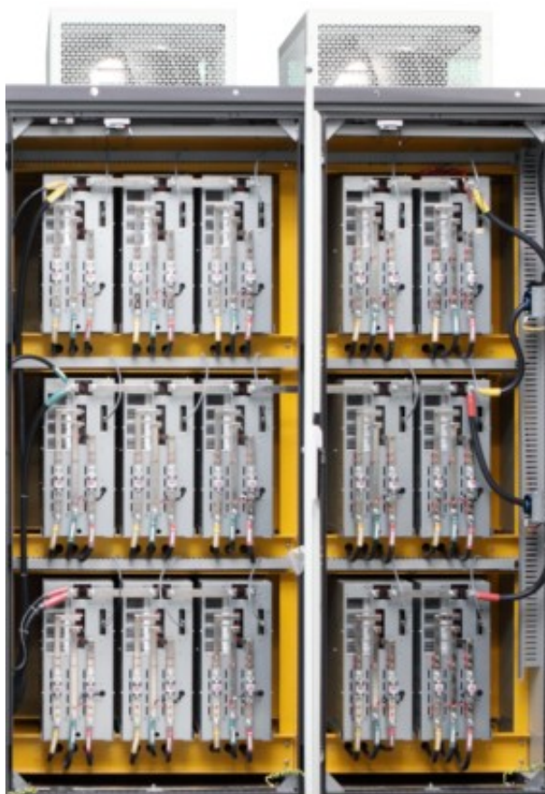
Рис. 3.7 Расположение компонентов в шкафу силовых модулей
