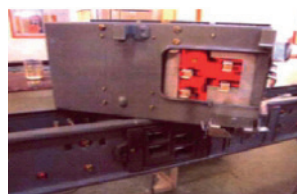
Работоспособность механических узлов
